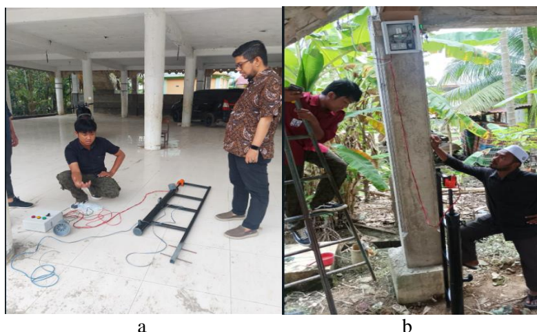
Gambar 5: a. Persiapan instalasi alat deteksi banjir, b. Alat deteksi banjir yang sudah di instal di ds. Cibrek Pirak, Aceh Utara
