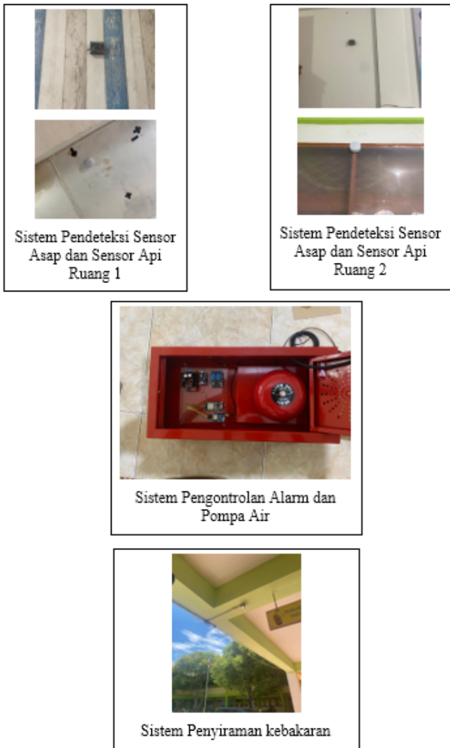
Gambar 4. Hasil instalasi sistem peringatan dan pemadaman kebakaran pada gedung sekolah Muhammadiyah
