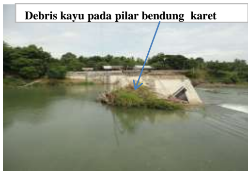
Gambar 3.6 Debris yang tersangkut pada bendung Karet
