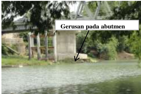
Gambar 3.5 Gerusan pada abutmen jembatan
