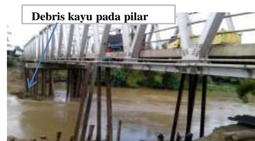
Gambar 3.3 Debris kayu yang merusak pilar
