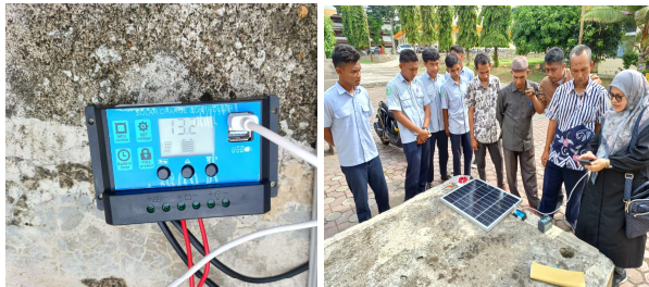
Gambar 6. Pengujian Komponen PJU PLTS
