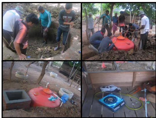
Gambar 5. Instalasi sistem biogas
