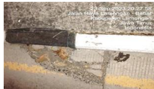
Gambar 4 Kerusakan Retak Sudut Sumber : Olahan Penulis, 2023
