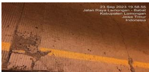
Gambar 7 Kerusakan Gompal Sudut Sumber : Olahan Penulis,2023
