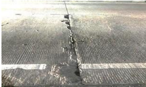
Gambar 5 Kerusakan Gompal Sambungan Sumber : Olahan Penulis,2023
