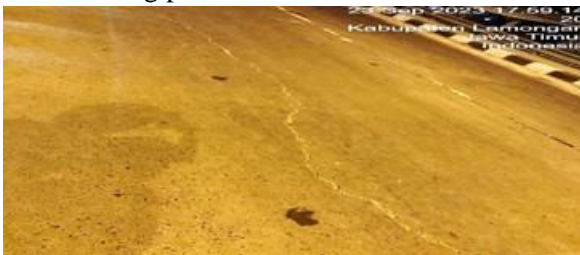
Gambar 2 Kerusakan Retak Linier Sumber : Olahan Penulis, 2023
