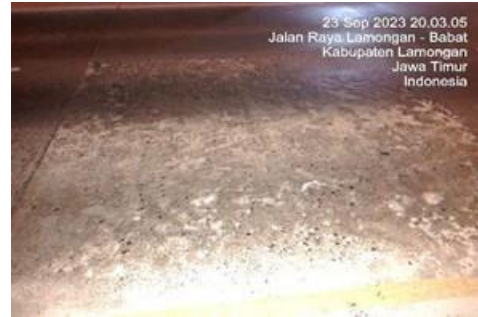
Gambar 3 Kerusakan Punch Out Sumber : Olahan Penulis, 2023
