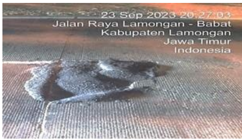
Gambar 6 Kerusakan Tambalan Kecil Sumber : Olahan Penulis,2023
