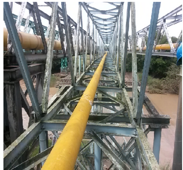
Gambar 25 Tampak Pipa Mengalami Kemiringan
