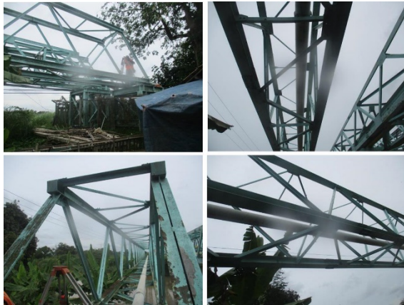
Gambar 2. Kondisi Karat Pada Jembatan dan Lubang Tanpa Baut
