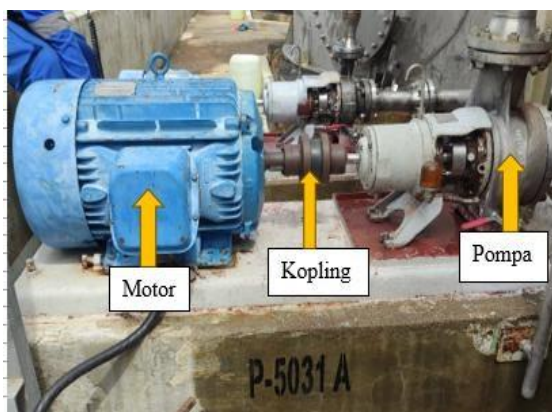
Gambar 1. Motor dan Pompa Sentrifugal P 5031 A.
