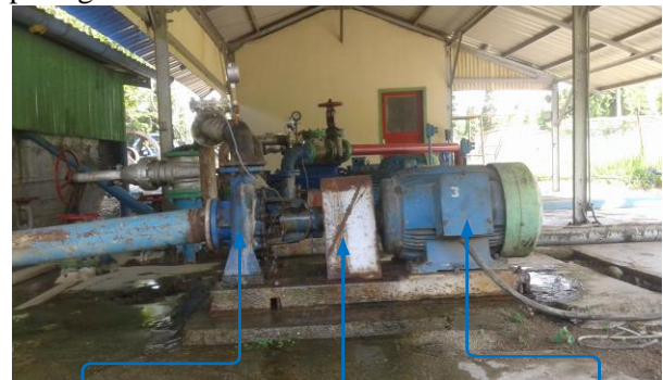
Gambar 3.2 Pompa centrifugal type KSB 65-160A yang ada di fasilitas water treatment plant
