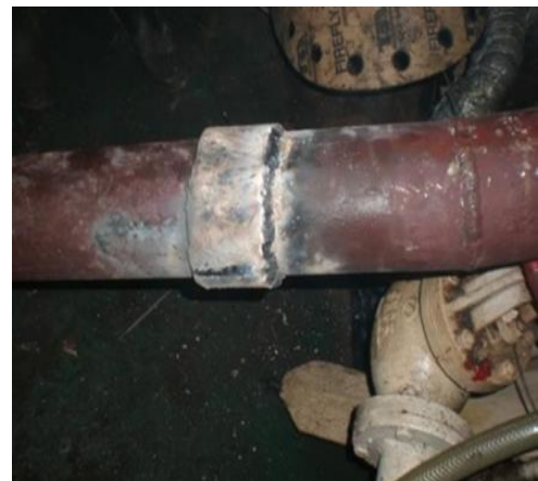
Gambar 2. 1 korosi galvanis pada penyambungan pipa ( Utomo, 2019 )
