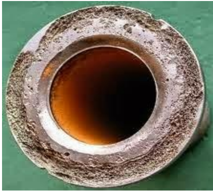
Gambar 2. 2 Korosi celah pada sambungan pipa ( Cramer dan Bernard, 2003 )
