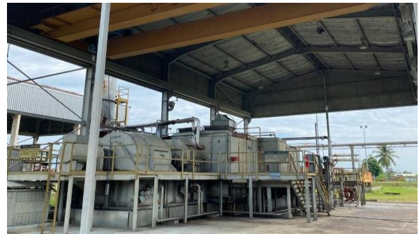
Gbr. 5 GE Turbin Gas PT.Pema Global Energi Tampak Depan
