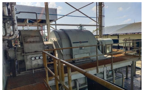
Gbr. 7 GE Alternating Current Generator Pada PT PGE
