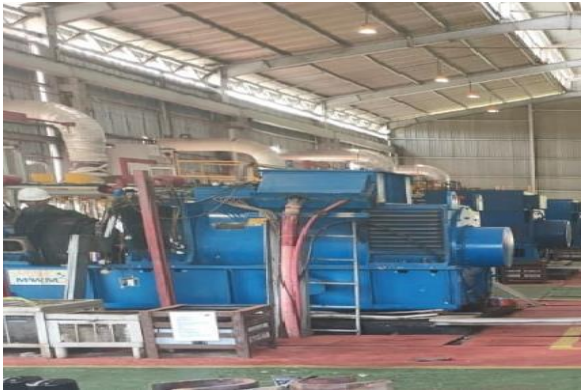
Gbr 1 Pembangkit Listrik Tenaga Mesin Gas PT. Pertamina Hulu Rokan Field Rantau (PT.PHR, 2022)
