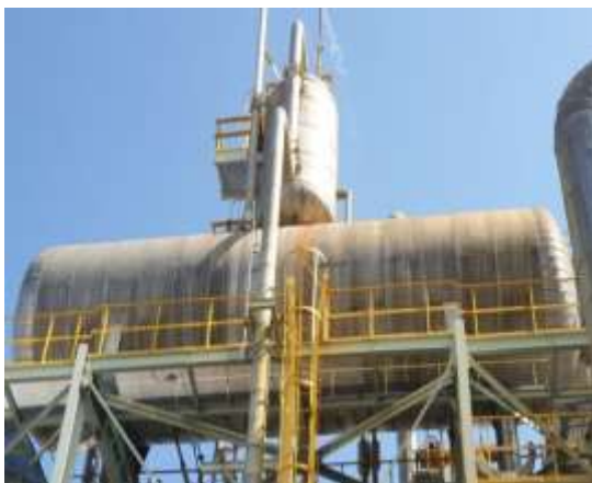
Gbr 1. Deaerator 101-U
