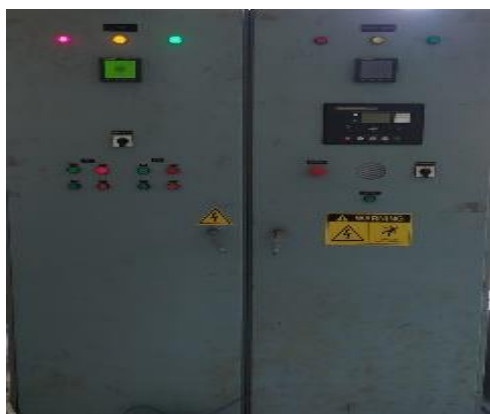
Gbr 1 Panel ATS Di Laboratorium
