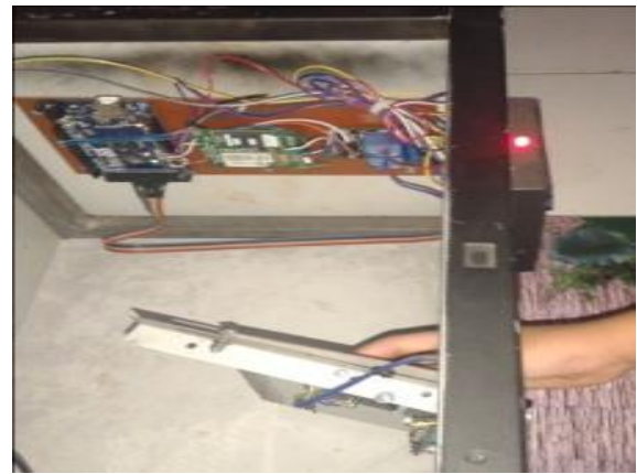
Gambar 11. Pengujian Limit Switch
